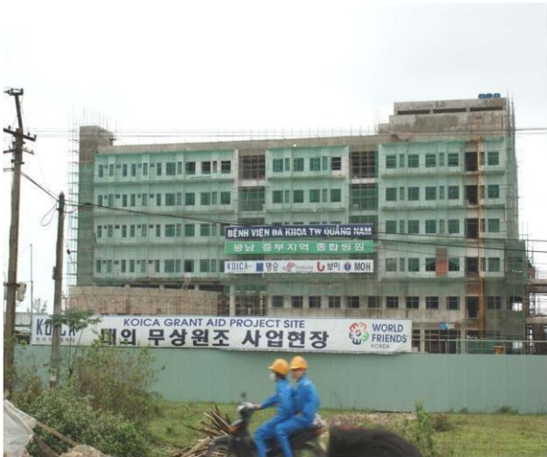
DỰ ÁN : BỆNH VIỆN ĐA KHOA TW QUẢNG NAM HẠNG MỤC : HỆ THỐNG ĐHKK
